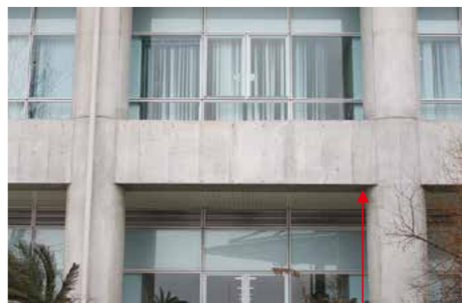
※2階外来フロアが1階より1mほどはみ出ている。
